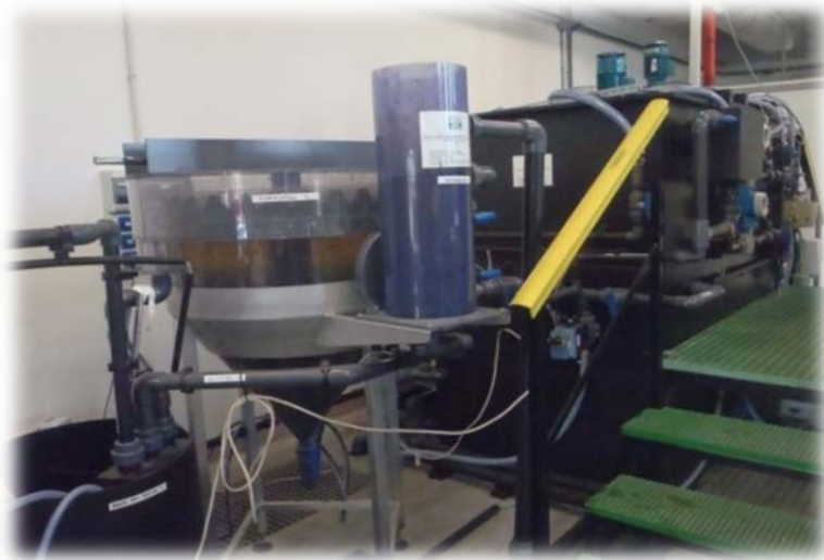
Pilote de station d'épuration implanté dans le hall de recherche de la Feyssine
