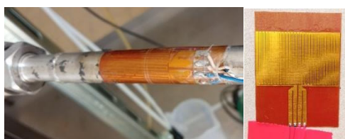
Figure 1. Sonde de détection de l'encrassement (droite) et sonde fixée sur un tuyau (gauche)
